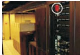
通信機房異常溫度偵側
